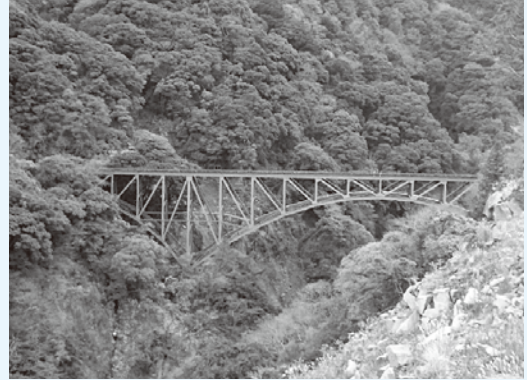
これから本格的な復旧工事が始まる第一白川橋りょう
