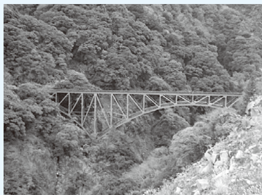
これから本格的な復旧工事が始まる第一白川橋りょう
