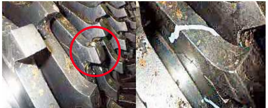
破損した破砕機
