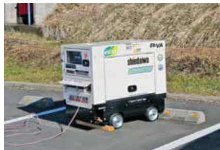
大型発電機 (1機)
