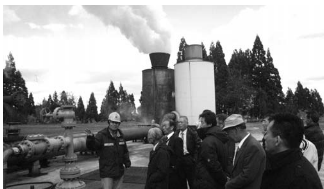
上の岱地熱発電所の生産井
