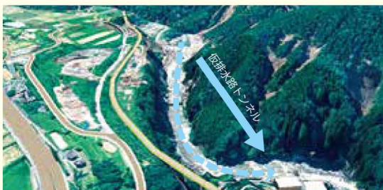
① ダム本体の工事をおこなうため、仮排水路トンネルを掘って一時的に白川の流れを切り替え
