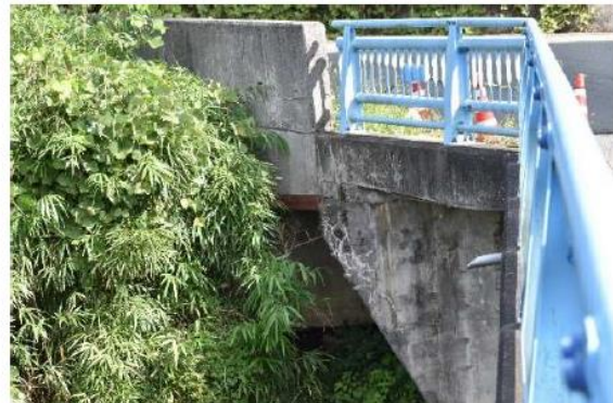
ASR劣化進行状況
