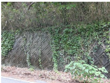
つる植物に覆われるコンクリート擁壁
