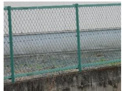
金網フェンス
