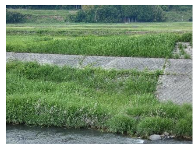
間地ブロックが草で覆われ始めている。
