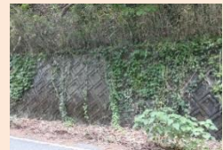
つる植物に覆われるコンクリート擁壁
