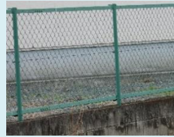
金網フェンス
