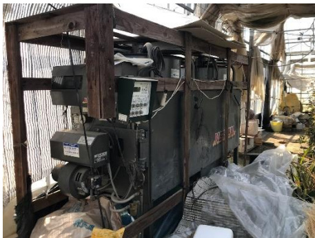
N 社製の重油ボイラー
