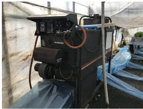
N 社製の重油ボイラー
