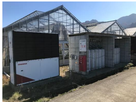
Y 社製のガスヒートポンプエアコン
