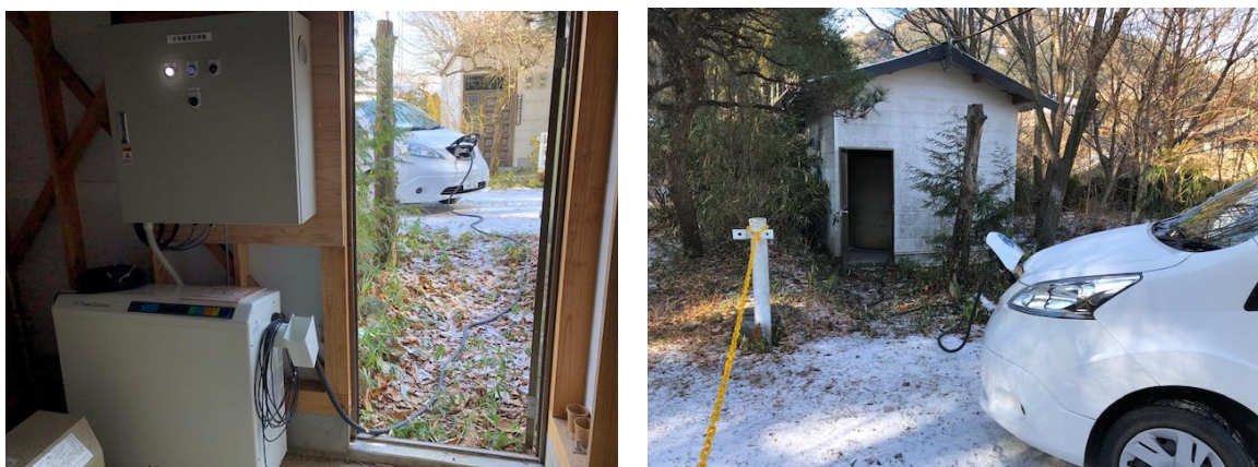
図表 64 非常用電源供給装置
