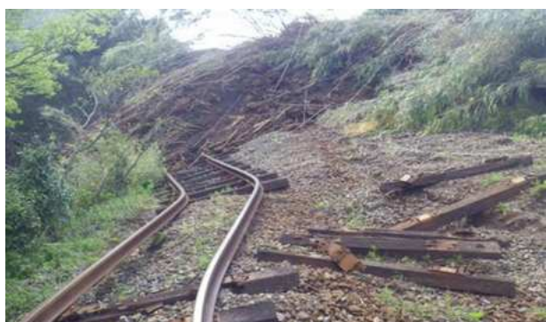
写真 激しい軌道変状
