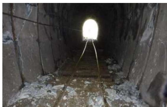
写真 犀角山トンネル内の亀裂
