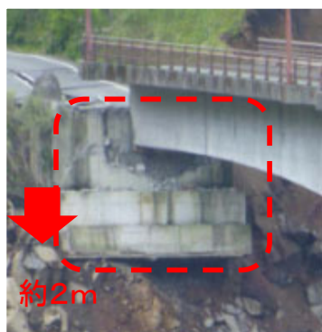
斜面崩落による橋台の沈下
