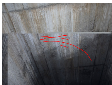
ひび割れの状況(内面側)
