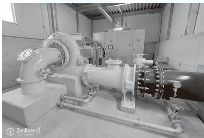
4月に運用を開始した南阿蘇村水力発電所(大字河陰)
