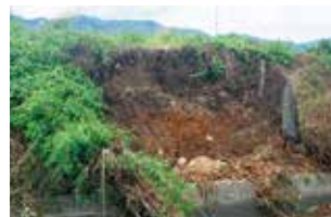
被災した農地の法面
