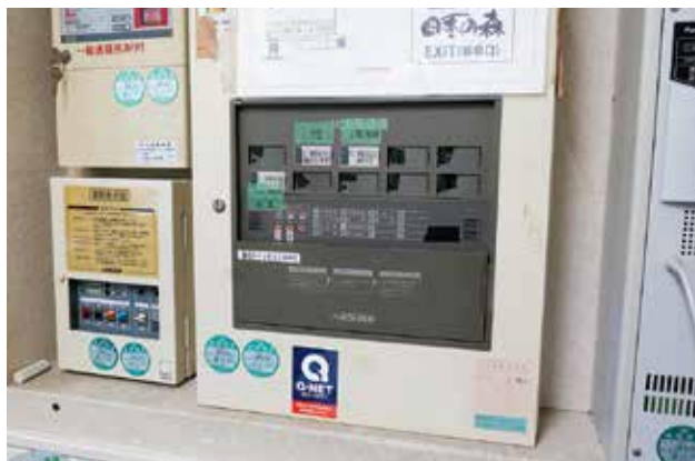
改修される火災受信機
