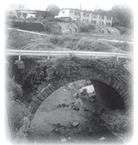
地震で被害を受けた床瀬川橋
