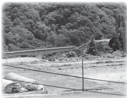
早期復旧が望まれる長陽大橋
