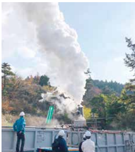
熱源となる蒸気の噴気試験
