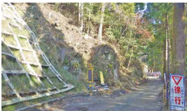
公共土木災害復旧費（熊本県代行工事喜多・垂玉線） 2100万円
