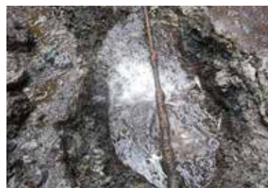
老朽化し破裂した水道管（中松3区内）
