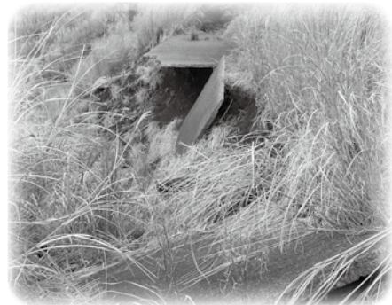
崩落し寸断された村道
