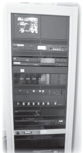
システム本体設備
