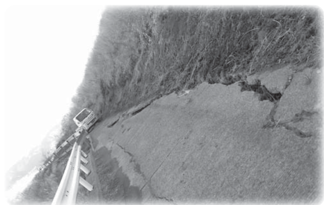
被害を受けた牧野道路
