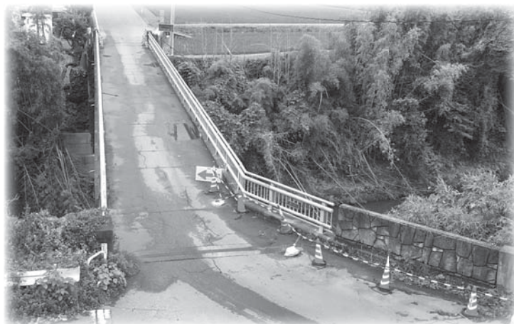
大型車両の通行規制が続く妙見橋
