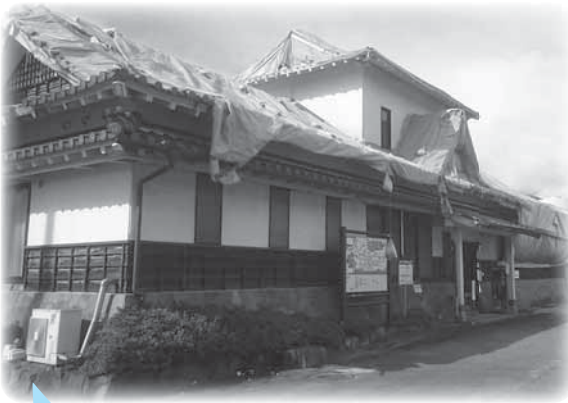
修繕を待つ下田城温泉 (設計業務委託510万円) (屋根シート修繕36万円)
