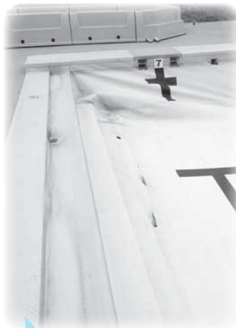
保護シートの傷みがひどい白水小プール (改修工事費2600万円)
